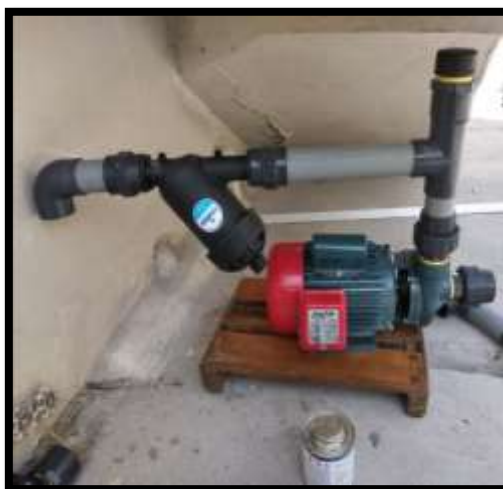
Ilustración 3-23: Ubicación de la bomba
