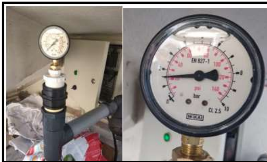
Ilustración 3-40: Medición de los aspersores Punto crítico
