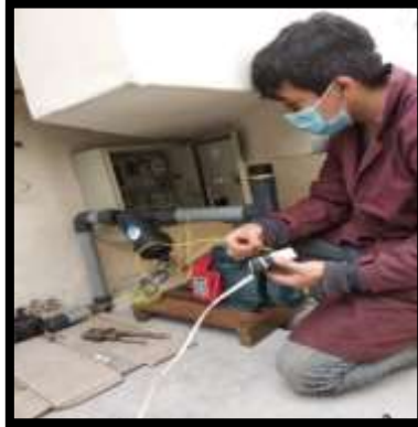
Ilustración 3-32: Pruebas de funcionamiento en la caja de control
