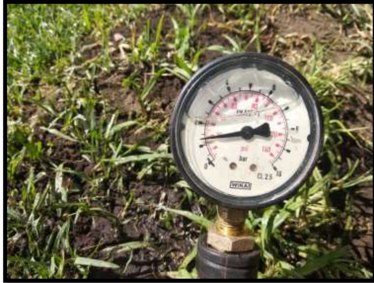
Ilustración 3-39: Medición de los aspersores Punto crítico 4
