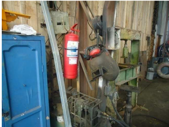
Figura 22. Implementos de seguridad en sitios no adecuados
