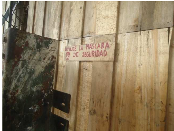
Figura 30. Señales sin las normas de señalización
