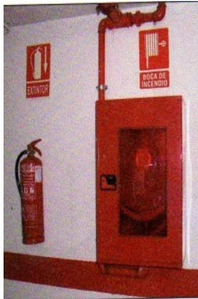
Figura 93. Extintor y boca de incendio equipado
