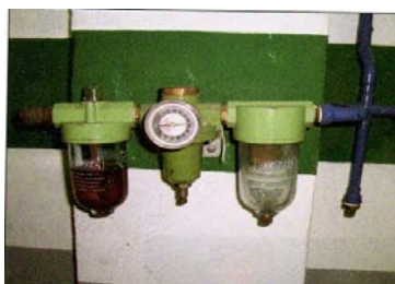
Figura 105. Aire en tubos flexibles
