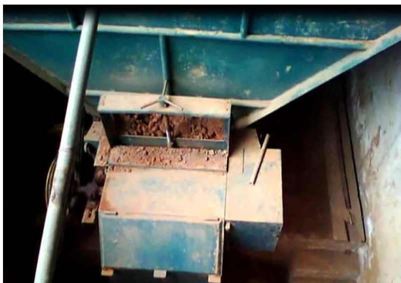
Figura 21. Desterronado en la parte baja del cajón alimentador.
