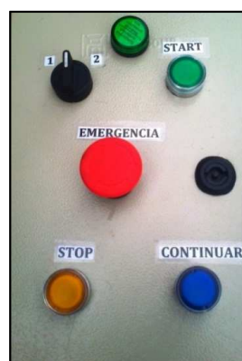
Figura 20. Tablero de control
