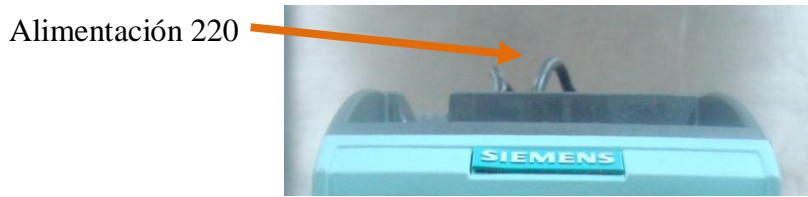
Figura 56. Conexión alimentación del variador.
