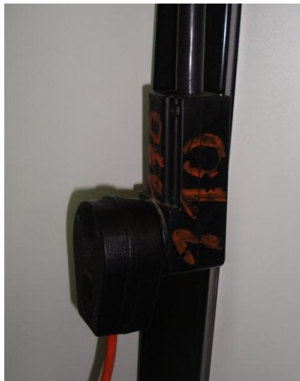
Figura 76. Conexión del banco a la toma de 220 V
