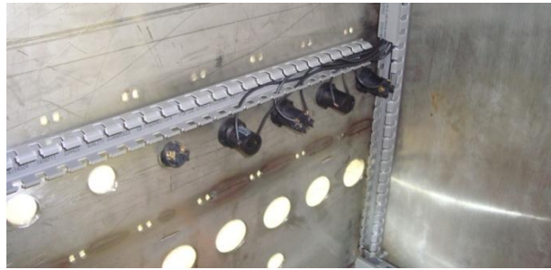
Figura 54. Conexión botonera circuito de control de la bomba
