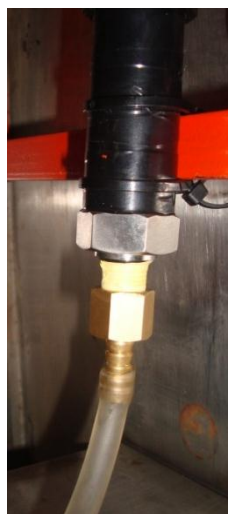
Figura 89. Drenaje de la toma del transductor
