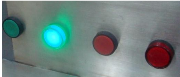
Figura 64. Encendido bomba centrífuga
