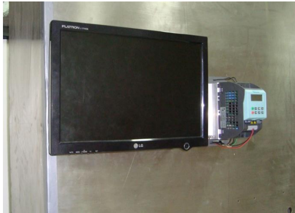
Figura 58. Montaje del monitor
