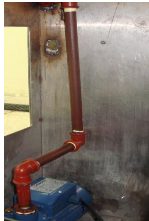
Figura 46. Conexión tubería de alimentación del tanque
