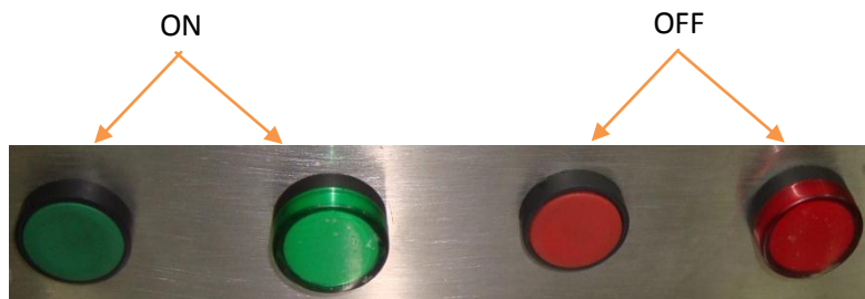
Figura 62. Botonera de control de la bomba centrífuga
