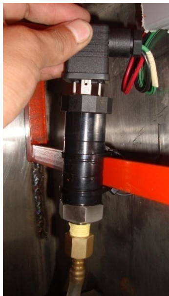
Figura 61. Montaje y conexión del transductor de presión
