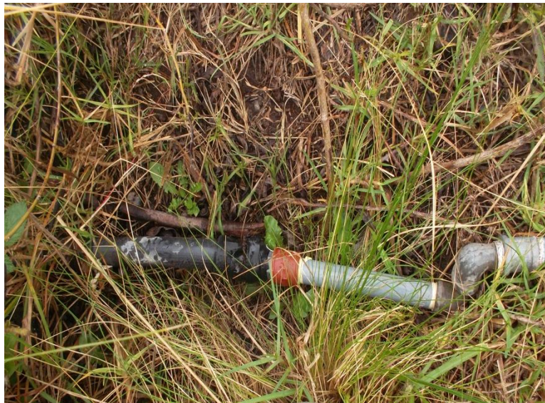
Fotografía 2-1 Tipo de Tubería
