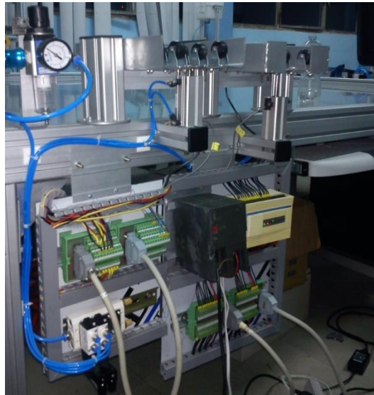
Ilustración IV-1: Tablero de control
