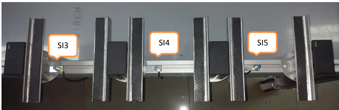
Ilustración III-29: Montaje de sensores inductivos para la estantería
