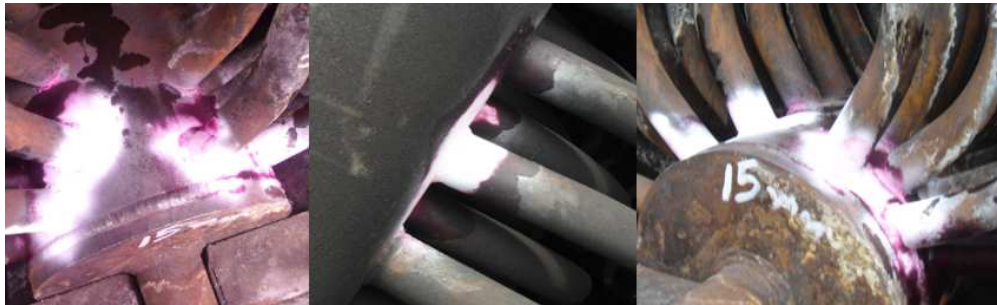
Figura 43. Ensayo de líquidos penetrantes
