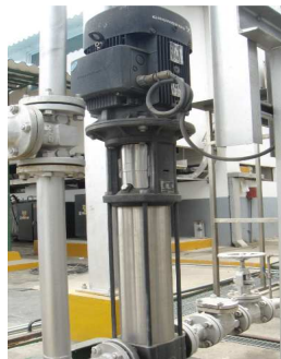
Figura 36. Bombas de alimentación
