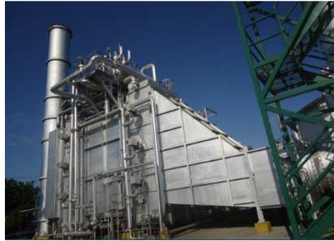
Figura 21. Caldera HRSG FRI-RLL
