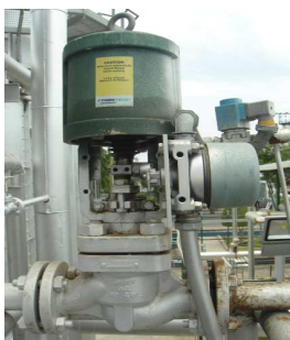
Figura 32. Válvula de control de alimentación de vapor
