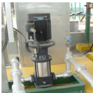
Figura 35. Bombas de condensado
