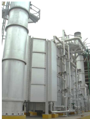
Figura 37. Carcasas caldera HRSG
