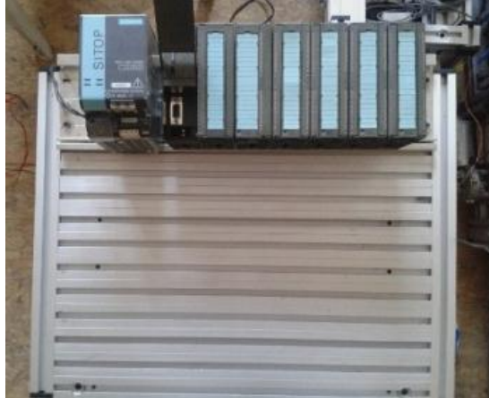
Figura 37. Montaje PLC S7-300 en el panel de control
