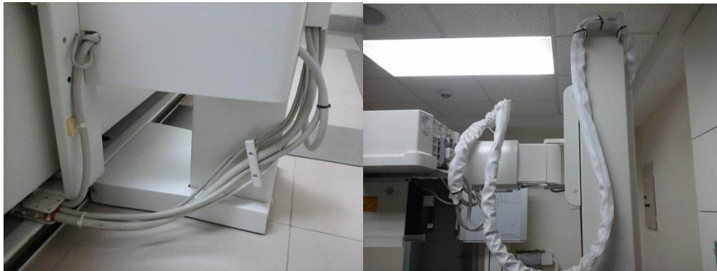
Figura 1-3. Aspecto visual bueno del cableado del equipo.
