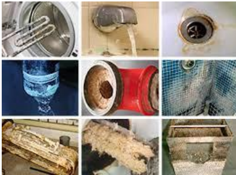
Ilustración 5-3 Incrustaciones en tuberías
