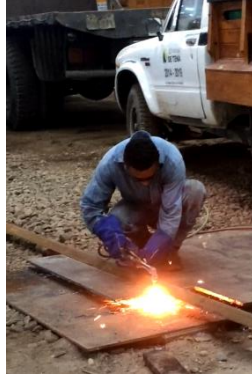
Figura 28. Puesto de soldadura – trabajador sin pantalla facial
