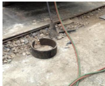
Figura 27. Puesto de soldadura - desorden
