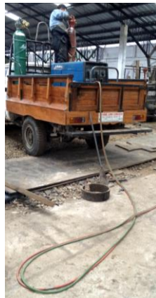
Figura 29. Puesto de soldadura – Ubicación inadecuada de cilindros de oxígeno y acetileno
