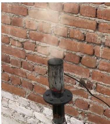
Figura 62-3: Presencia de gas pobre
