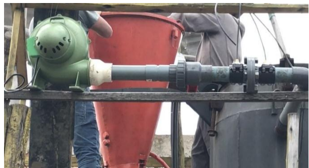
Figura 55-3: Conexión tuberías y blower
