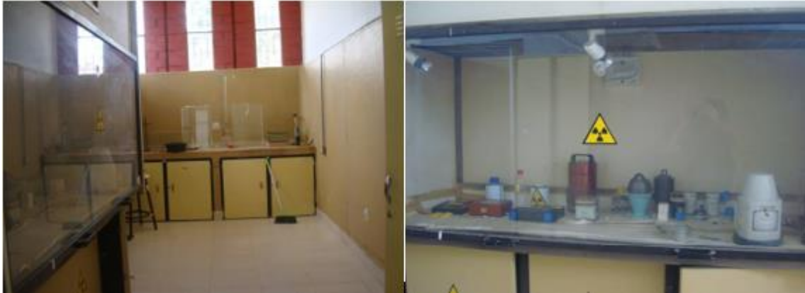
Figura 1-2. Campana de gases del LTN.
