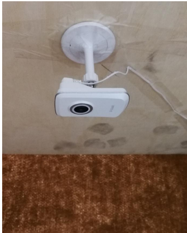
FOTOGRAFÍA 4A. Cámara D-link.
