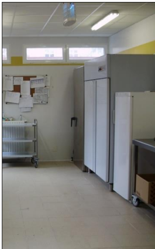
FIGURA N °16: ÁREA DE REFRIGERACIÓN Y CONGELACIÓN
