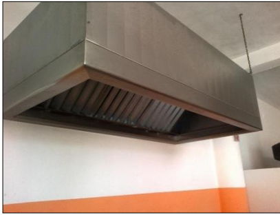
FIGURA N °28: SISTEMA DE EXTRACCIÓN
