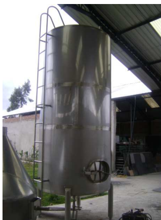
Figura 3.10. Tanque de almacenamiento de 3000 Lt.
