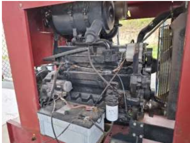
Ilustración 11: Motor de la bomba estacionaria de recarga
