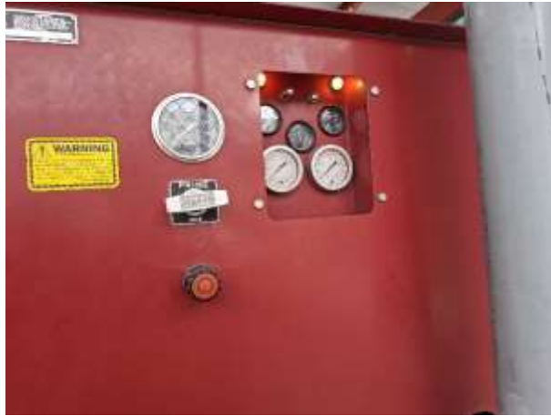
Ilustración 10: Medidores de la bomba estacionaria de recarga
